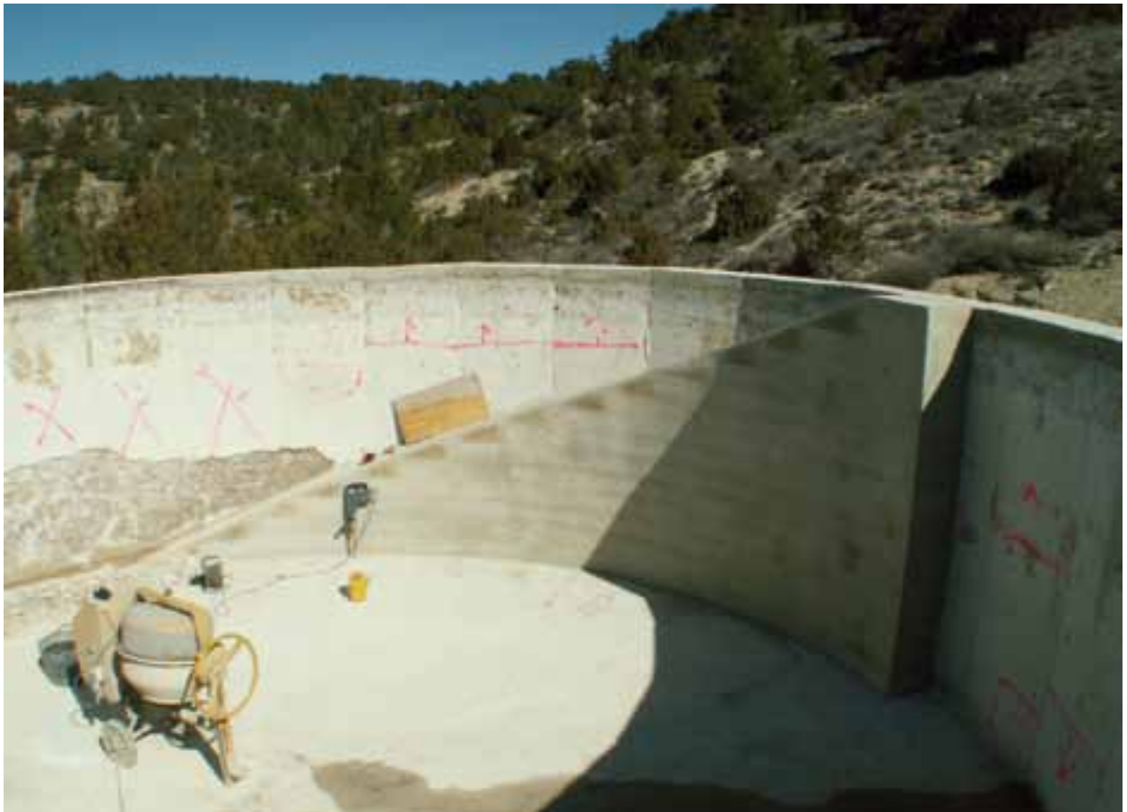
Fuente de las Blancas (La Puebla de San Miguel). Instalación de una rampa de escape en un depósito antiincendios.
