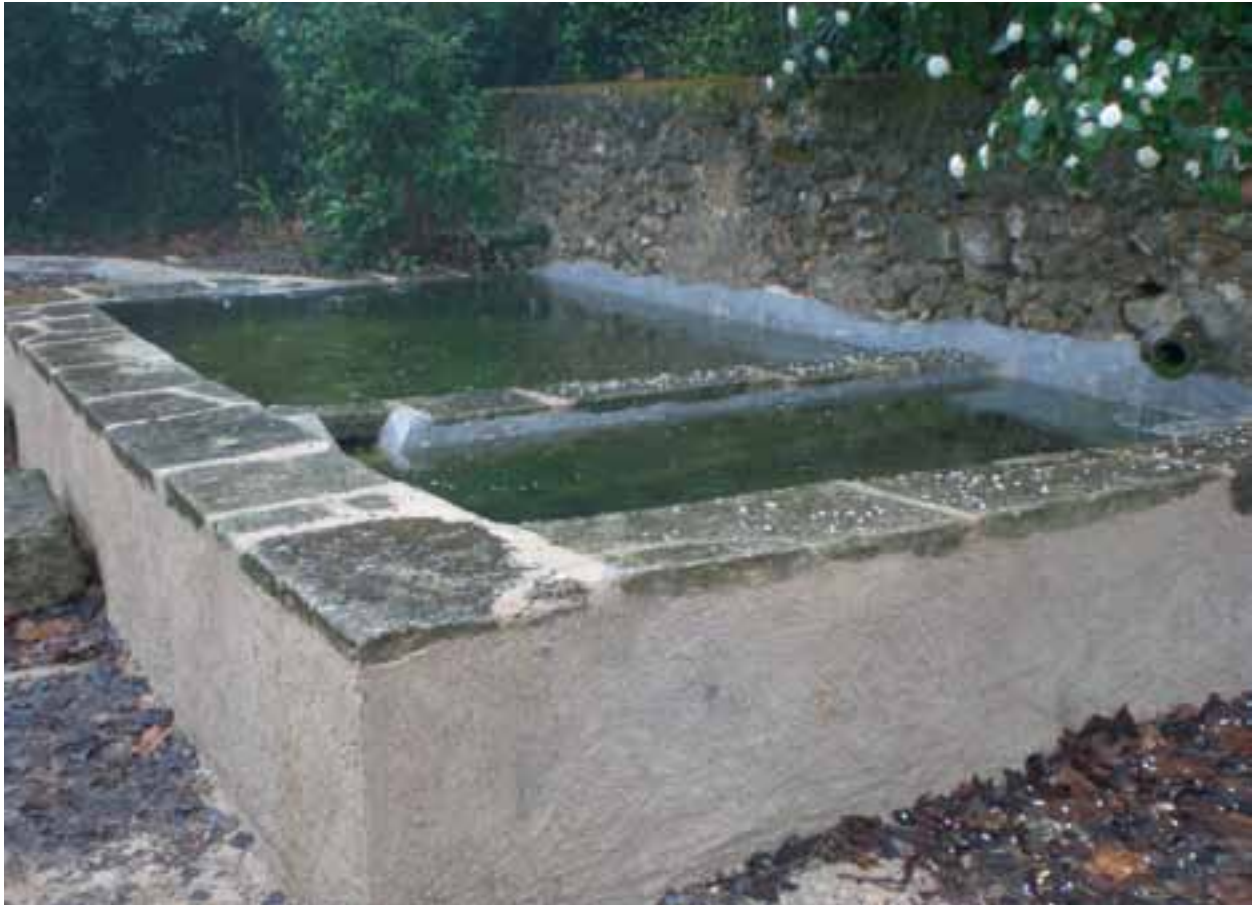
Mas de Celedón (Alcoi). Mediante la impermeabilización de grietas y redireccionamiento del caudal se ha recuperado la funcionalidad de estas balsas asociadas a una fuente del Parque Natural del Carrascar de la Font Roja.
