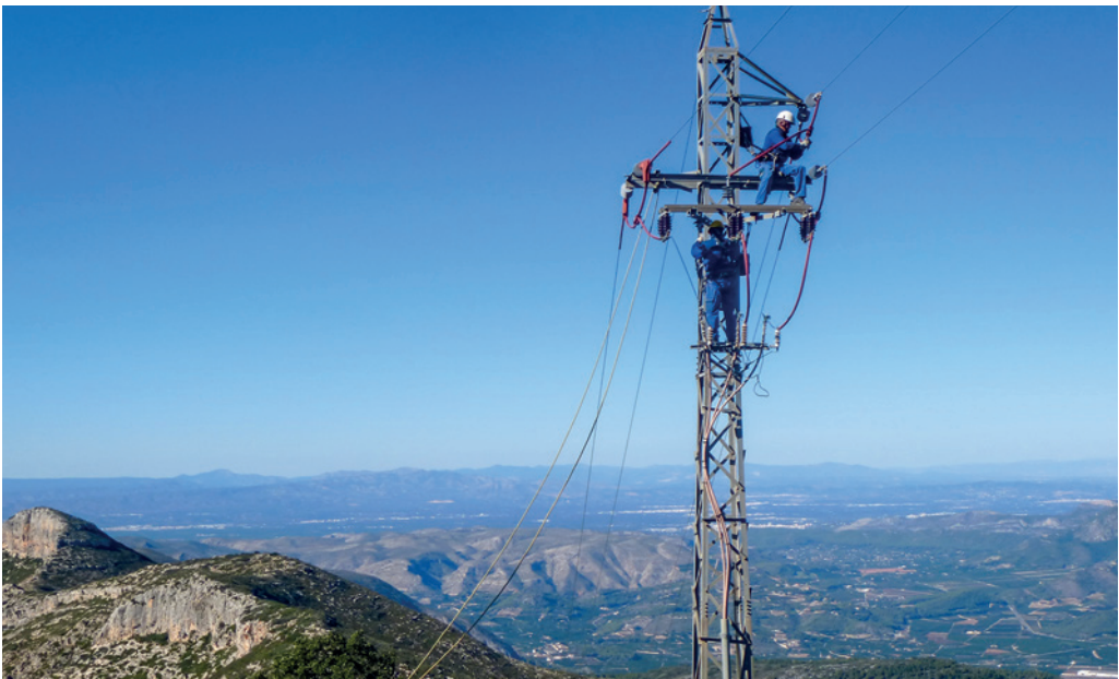
Corrección de un tendido eléctrico de la línea Montdúver-Marjal de la Safor. Fotografía: Servicio de Vida Silvestre.
